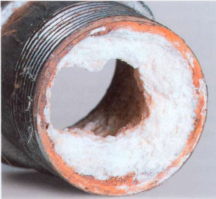
Mineralische Ablagerungen (Wasser- oder Kesselstein)
